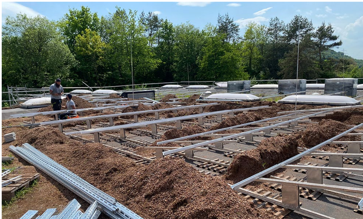
PV-Anlage Engerfeld: Erweiterung der Anlage.
