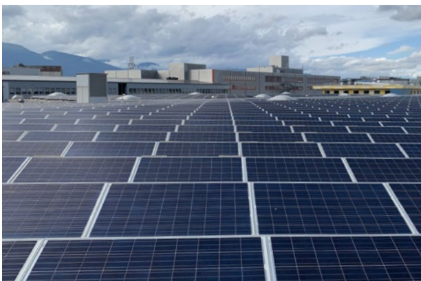
Die PV-Anlage in Moulières erstrahlt nach der Reinigung in neuem Glanz.
