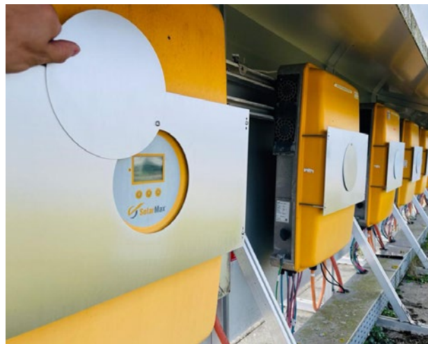
Neue Displayabdeckungen an den Wechselrichtern der PV-Anlage Rothenburg schützen die heiklen Kunststofffolien der Anzeige.
