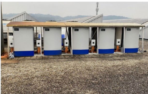
PV-Anlage Rollstar: Wechselrichter mit neuen Wartungsschaltern.
