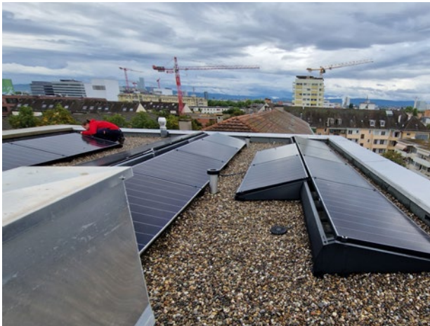
PV-Anlage Christophorus: Kritischer Blick unter die Module beim jährlichen Anlagencheck.
