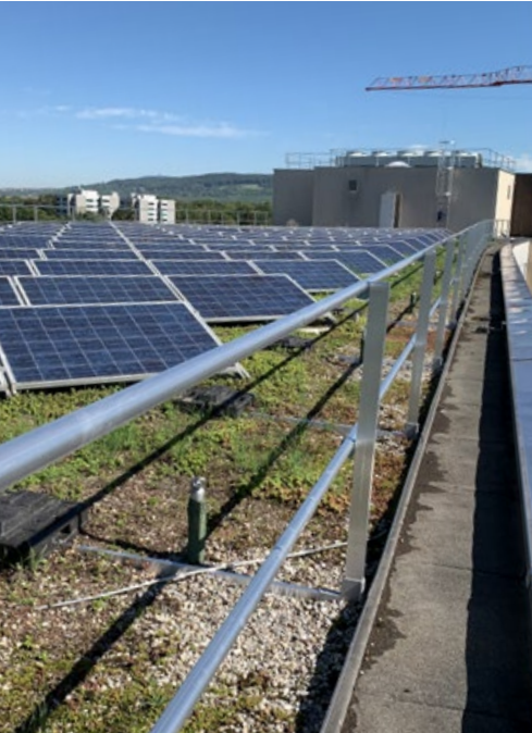
Abb. 9: PV-Anlage Claraspital: Der Mietvertrag für das Dach konnte verlängert werden. Die über 20-jährigen Sekuranten (vorne links) wurden ausser Betrieb genommen und durch ein Geländer ersetzt.
