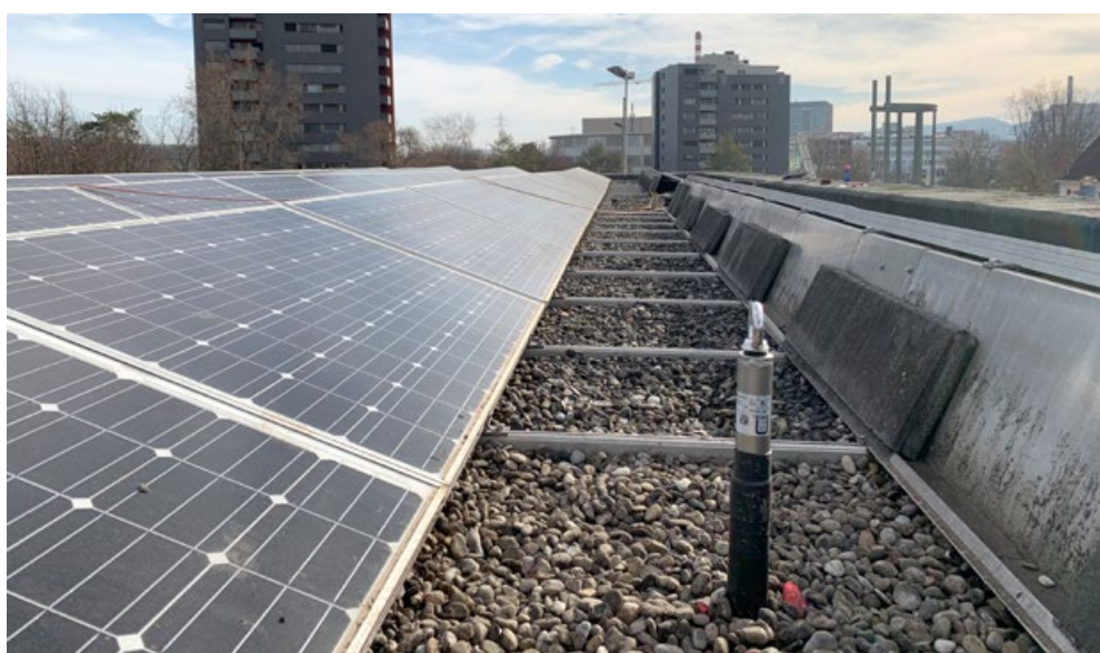
Abb. 16: Der Zustieg zur PV-Anlage Donnerbaum in Muttenz ist sicher (Korbleiter rechts hinten). Aber die Attika ist nur 20 cm hoch. Deshalb musste die Anlage mit Sekuranten nachgerüstet werden (vorne).
