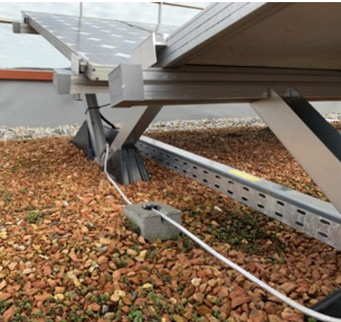
Abb. 11: Eine weitere Neuanlage, PV Kopfbau 118 in Winterthur. Die speziell für Gründächer entwickelte Unterkonstruktion erlaubt eine erhöhte Montage der Module, vgl. dazu Abb. 14, S. 12.
