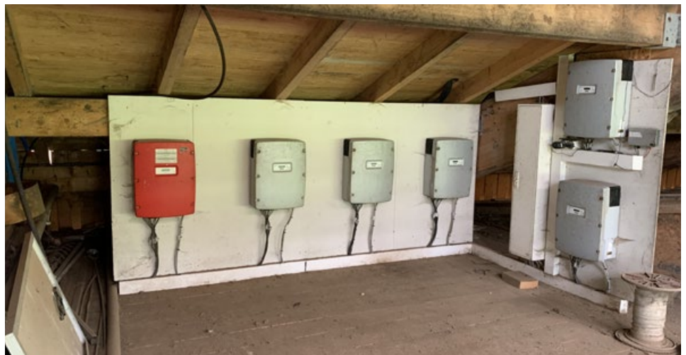
Abb. 13: Nicht nur die Module müssen periodisch gereinigt werden: Stark verstaubte «Wechselrichterecke» in Rettenberg vor der Reinigung.
