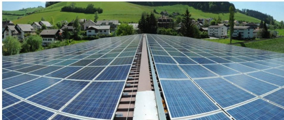
Abb. 1: PV-Anlage in Walkringen: Auf Anfrage übernimmt die Alteno Solar AG Altanlagen zum Weiterbetrieb. Die Haupttätigkeit der Alteno Solar AG bleibt der Neubau und Betrieb von PV-Anlagen mit dem Ziel, bei der Ökologisierung des Schweizer Strommixes mitzuarbeiten.
