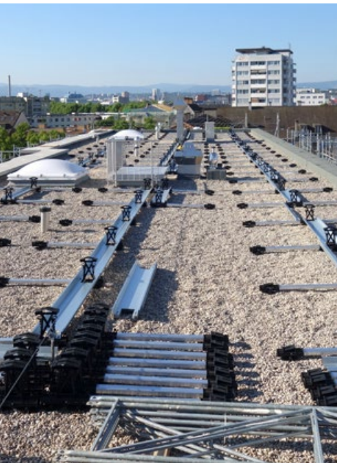
Abb. 2: Eine der drei Neuanlagen: Unterkonstruktion der PV-Anlage Christophorus auf dem Dach des neuen Kirchgemeindehauses in Kleinhüningen in Basel.
