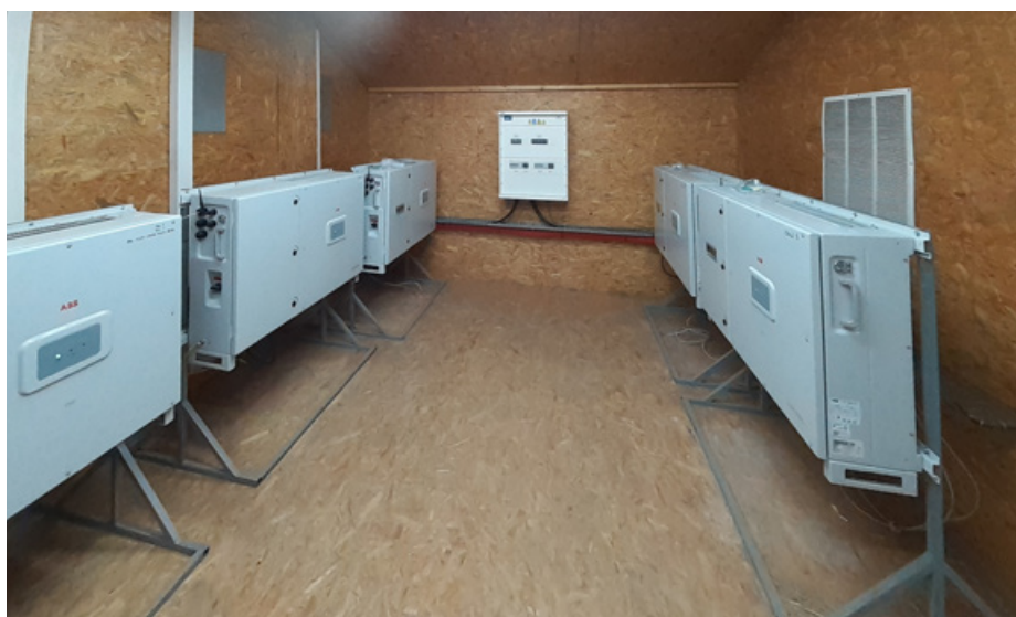
PV Valleiry: Situation nach dem Wechselrichterumbau
