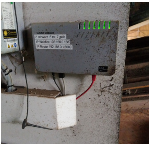
Raue Bedingungen für die Fernüberwachung im Kuhstall der PV-Anlage Holzer (D)
