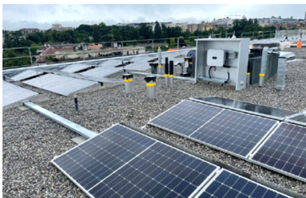
Die neue PV-Anlage Rue Hoffmann in Genéve mit einer Leistung von 45 kWp
