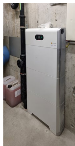
ZEV-Steinbühlweg mit fünf Gebäuden: links Tableau mit Smart Metern und HKN-Zähler. Rechts: In vier Gebäuden wurden Batterien mit je 15 kWh Kapazität eingebaut. Batterien dieser Grösse dürfen in Technikräumen aufgestellt werden. Fotos: Lorenz Matter
